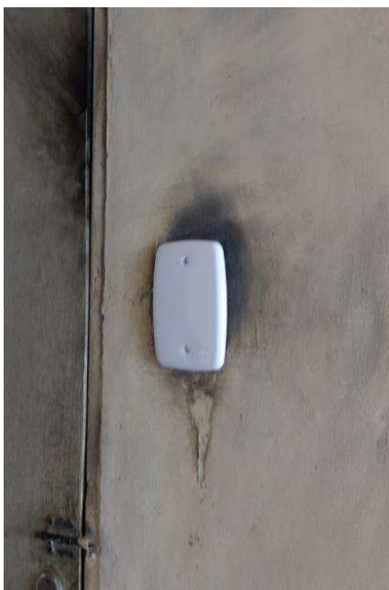
Figura 3.4: Resquício de início de incêndio.
