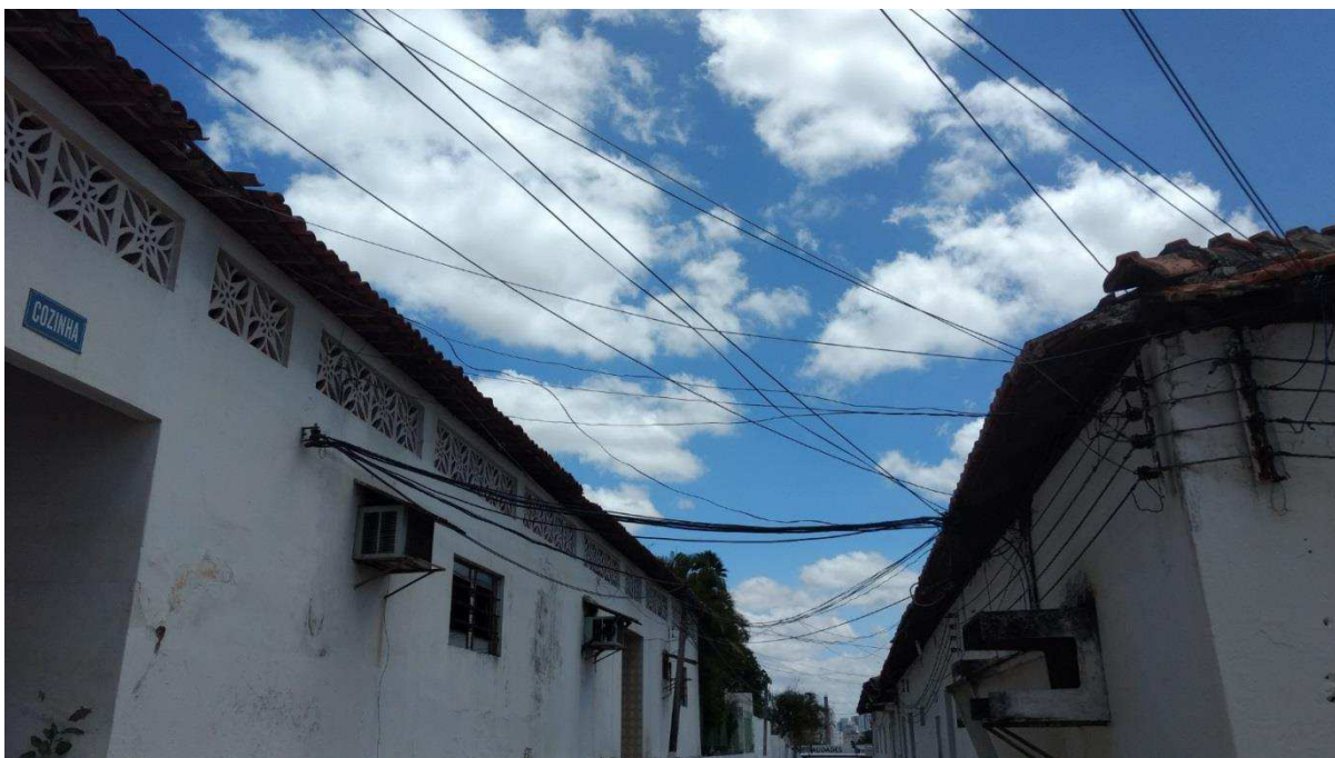
Figura A.10: Parte da fiação externa.
