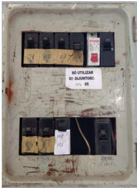
Figura A.13: QD1 do bloco administrativo com a tampa de proteção.
