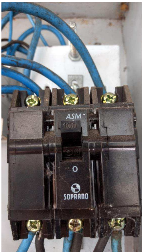
Figura A.4: Disjuntor tripolar 100 A.
