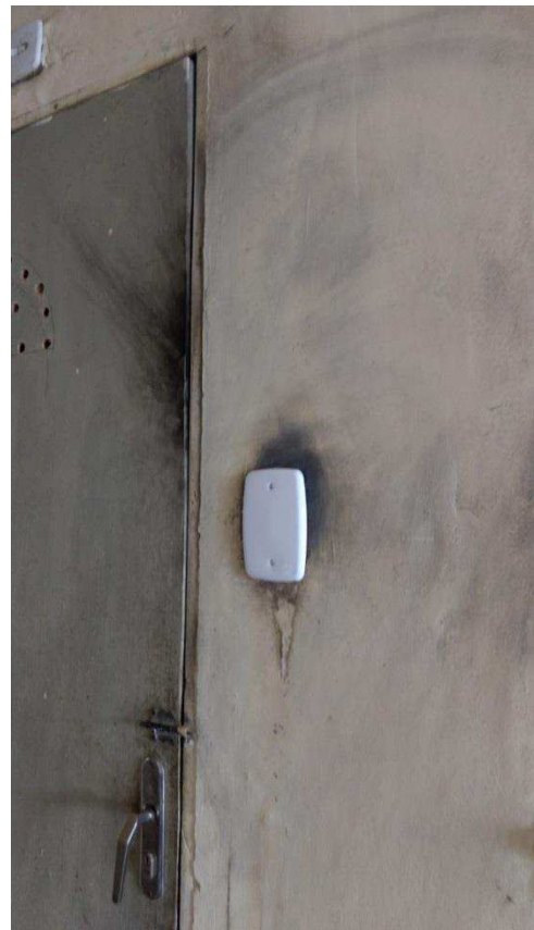
Figura A.9: Resquício de início de incêndio.
