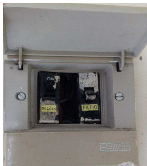
Figura A.16: QD3 do bloco administrativo.
