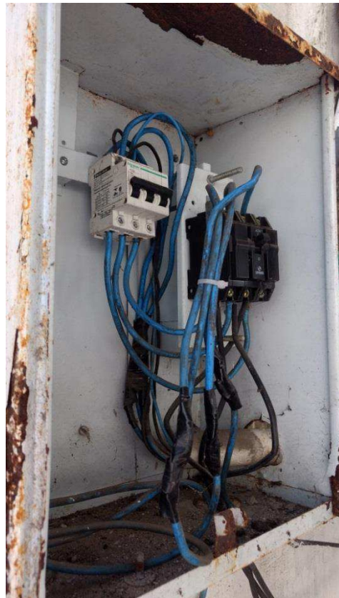
Figura A.2: QGBT, visão interna.
