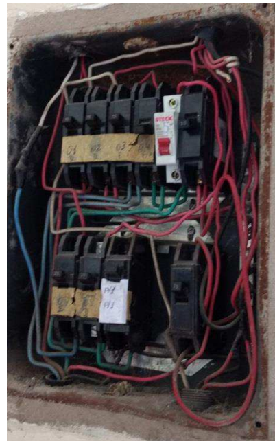
Figura A.14: QD1 do bloco administrativo sem a tampa de proteção para verificação da fiação.
