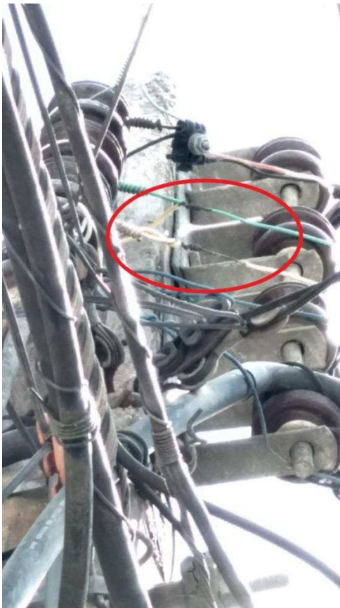
Figura A.8: Condutores sem isolamento.
