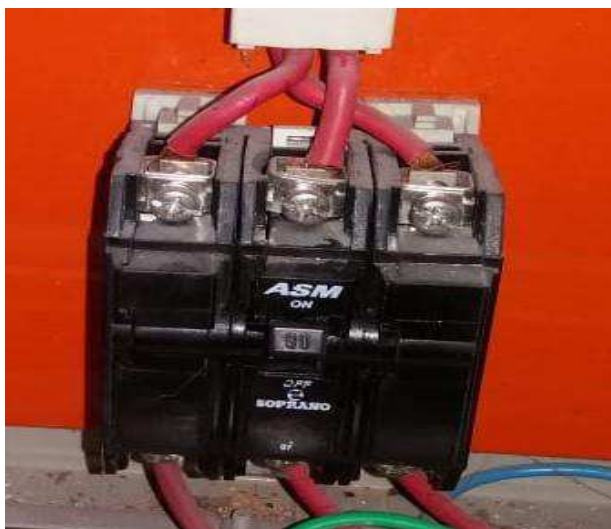
Figura 16: Disjuntor trifásico termomagnético 90 A de entrada do CPR-1.
