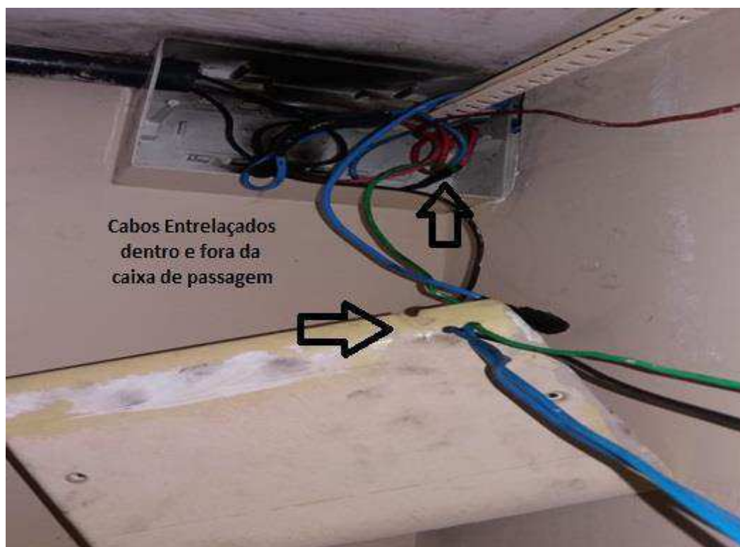
Figura 18: Entrelaçamento de cabos e ambiente impróprio para emendas.
