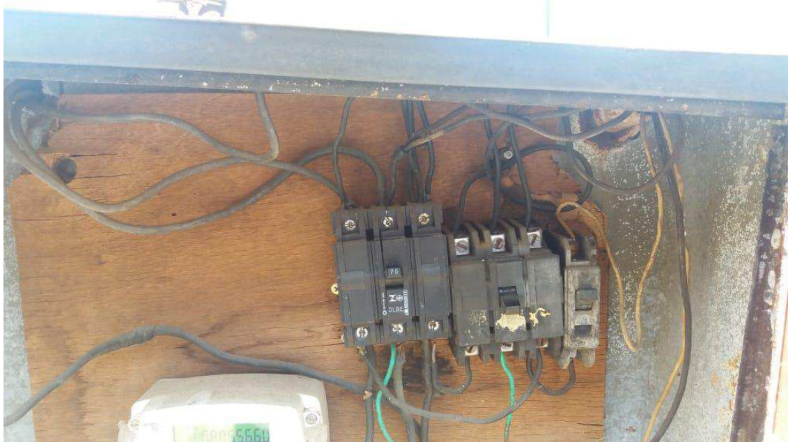
Figura 10: Quadro de disjuntores deteriorado do 4º Batalhão de Polícia da Paraíba, em Guarabira.
