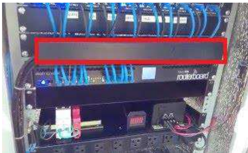
Figura 8: Armário de telecomunicação com destaque para a guia de organização de cabos.
