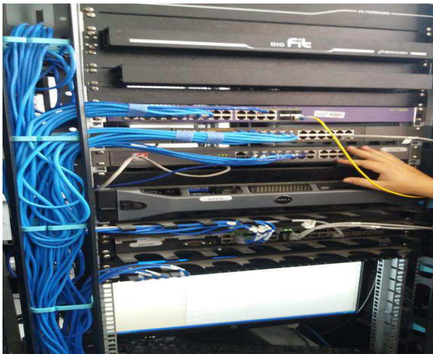
Figura 3: Armário de telecomunicação do CPR I.
