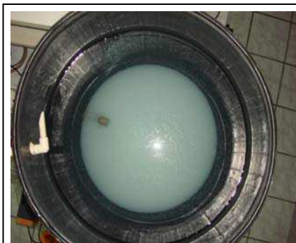
Figura 3.10 – Vista superior do tanque decantador, observando-se o precipitado formado no processo.
