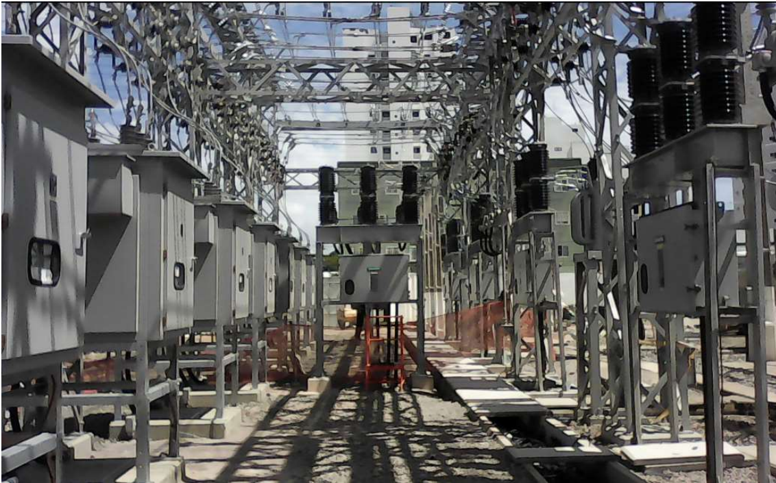
Figura 3: Módulo 1 de 13,8kV da SE Imbiribeira
