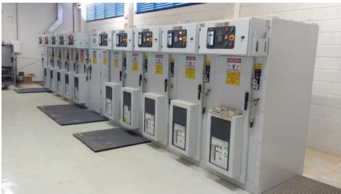
Figura 10 – Sala de Distribuição em Média Tensão – Unidade 10.
