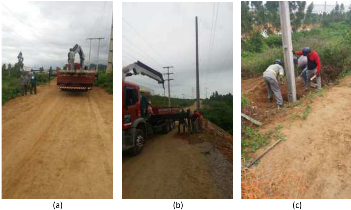
Figura 21 – (a) Carregamento dos postes. (b) Alocação dos postes com caminhão munck. (c) Alinhamento e compactação da base do poste com concreto – Via de Acesso Unidade 10.
