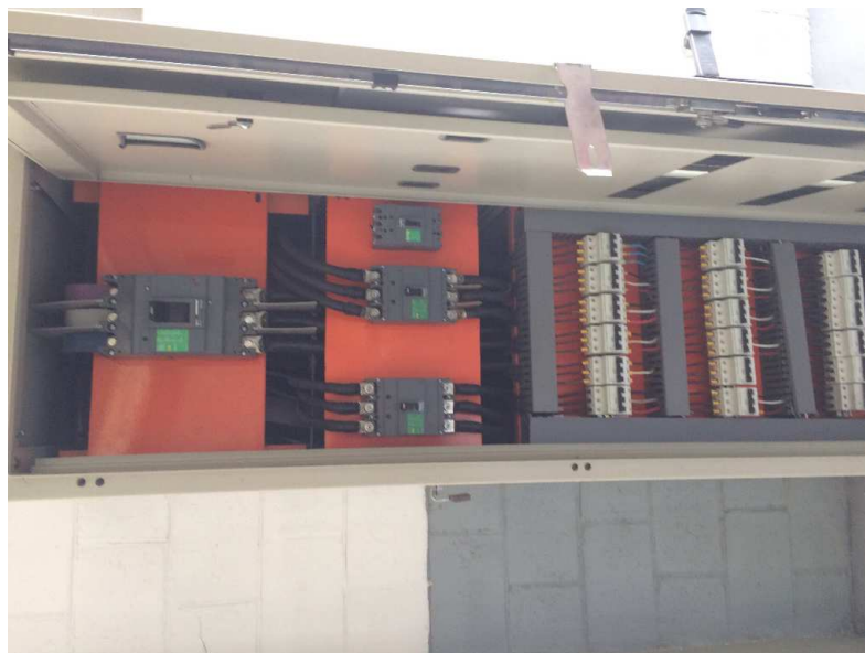
Figura 15 – QGBT de máquinas (QGDF311) da oficina matrizaria. Fonte: Autor.
