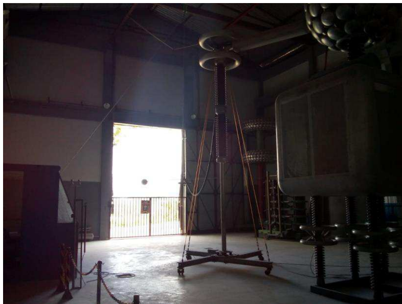
Figura 4 – Salão de Alta Tensão.
