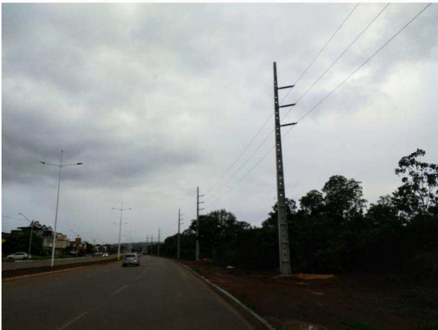
Figura 16: Trecho da LDAT 138kV (II)
