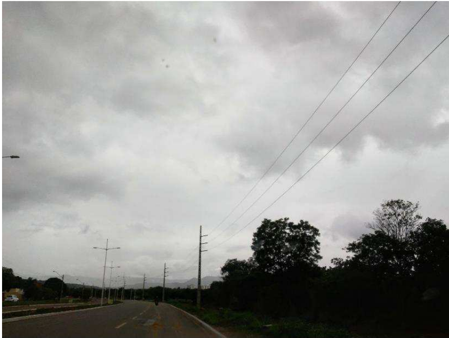
Figura 15: Trecho da LDAT 138kV (I)
