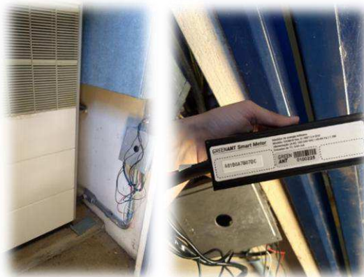
Figura 8: Medidor inteligente instalado em um climatizador.
