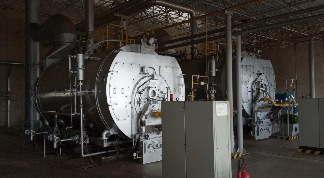
Figura 9 – Caldeiras a gás natural do setor das utilidades.
