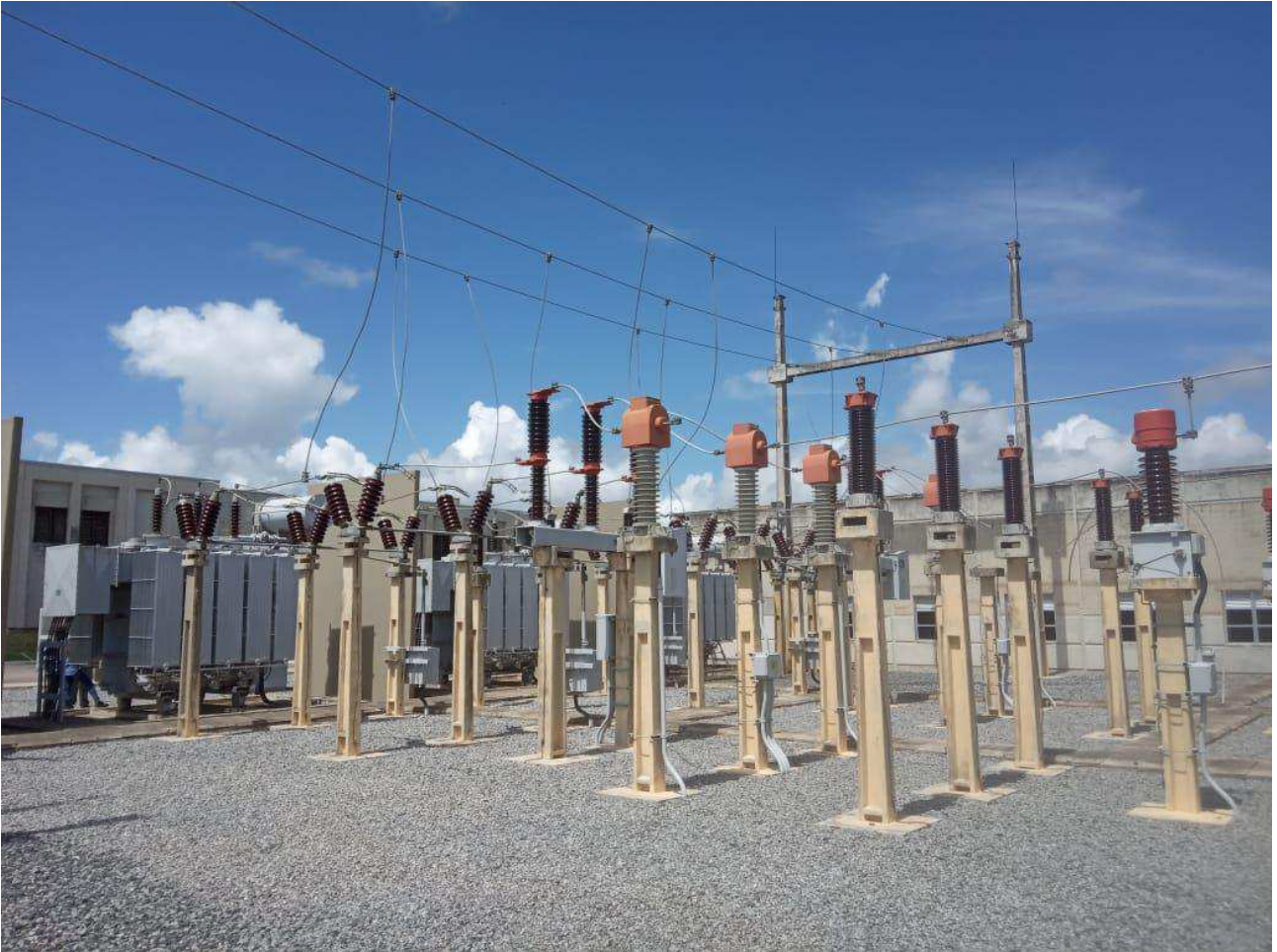
Figura 12 – Subestação de 69 kV da Coteminas - unidade Campina Grande.
