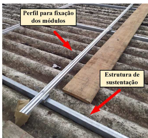
Figura 14 – Estrutura para fixação dos módulos.
