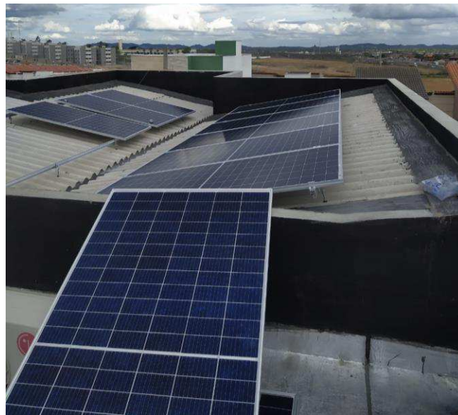
Figura 13 – Módulos fotovoltaicos em telhas de fibrocimento.
