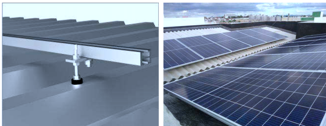
Figura 17 – Módulos fotovoltaicos em telhas de fibrocimento.
