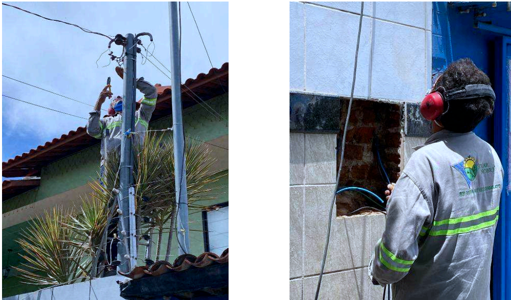
Figura 23 – Conexão do sistema fotovoltaico.
