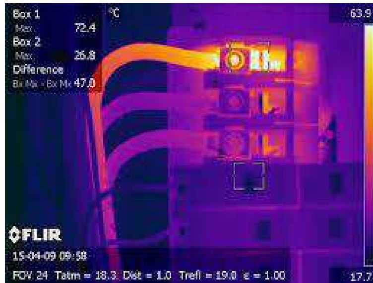
Figura 16 - Termografia de uma conexão inapropriada.
