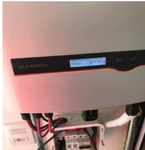
Figura 17 - Inversor Sungrow desconectando por sobretensão apresentando erro 002 no display .
