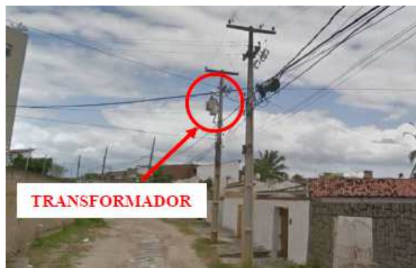
Figura 14 – Trecho da Linha de Distribuição Conectado com o Transformador no Local do Estudo de Caso.
