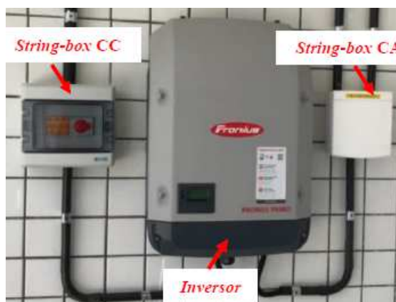
Figura 13 – Equipamentos Instalados no Local do Estudo de Caso.
