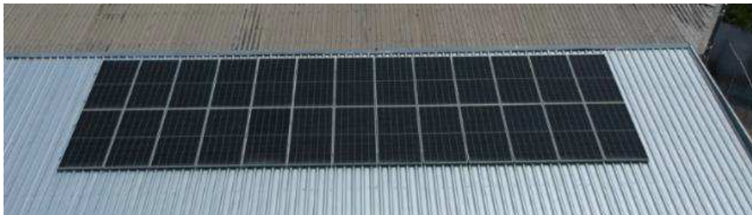
Figura 12 – Painel Solar Instalado no Local do Estudo de Caso.
