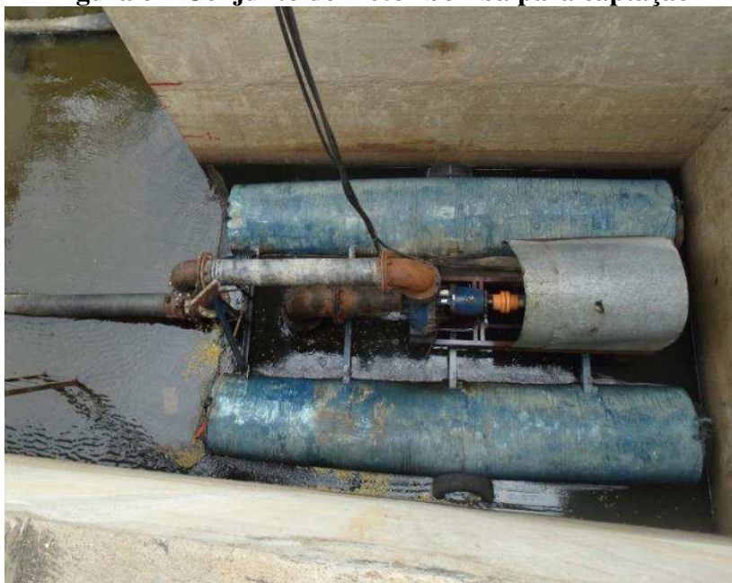
Figura 8 – Conjunto de motor bomba para captação
