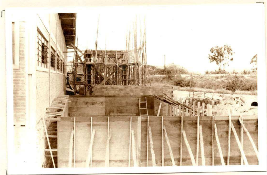
Reservatório Superior e Inferior e Casa de Bombas
