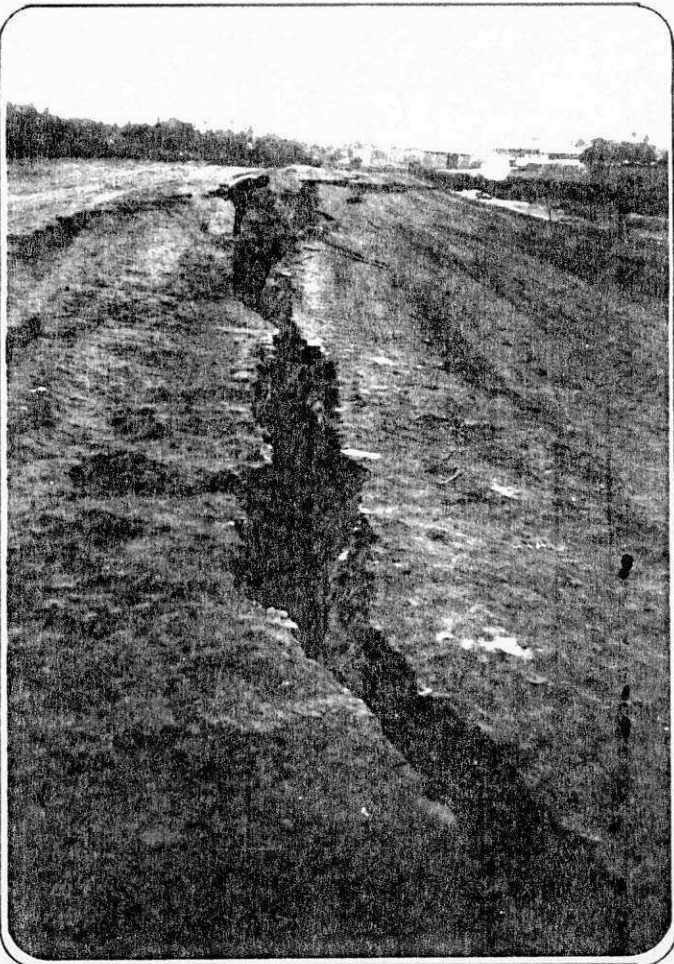
FOTO 05 - Vista do aterro Avenida Nova Liberdade, detalhando as ruturas ocorridas.
