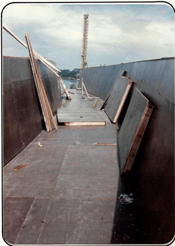
FOTO 12 - Confeção de fôrmas da viga unice-lular do Ramo Ci-dade, em madeirit plastificado.
