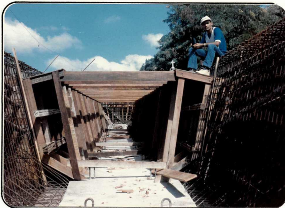
FOTO 15 - Vista da ferragem e da fôrma da viga da pista direita. Na foto percebemos perfeitamente que a viga é unicelular.
