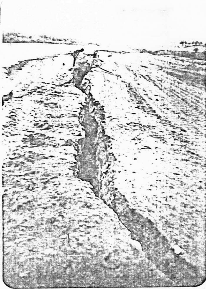
Foto 6 - Vista do aterro desta Avenida, detalhando as ruturas ocorridas.
