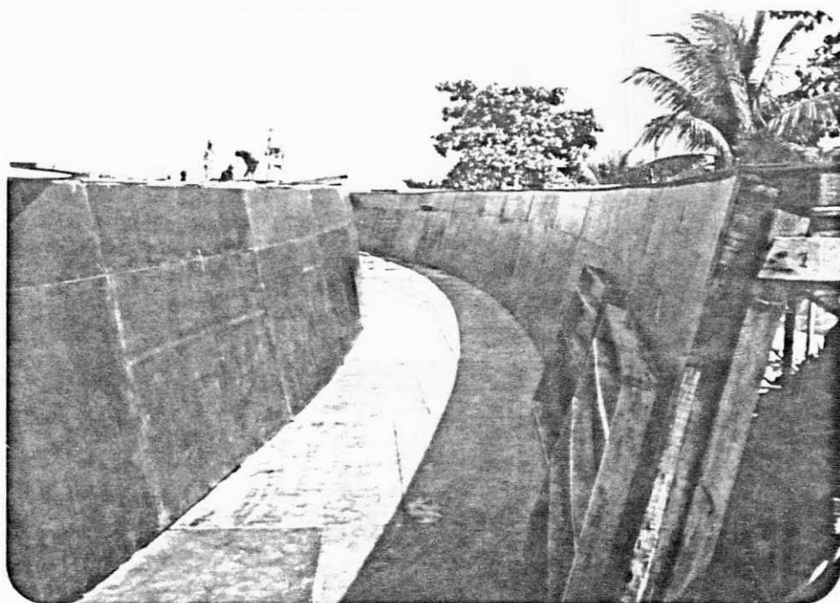
Foto 29 - Panorâmica das formas de madeira' colocadas na laje inferior e nas vigas laterais do ramo cidade.
