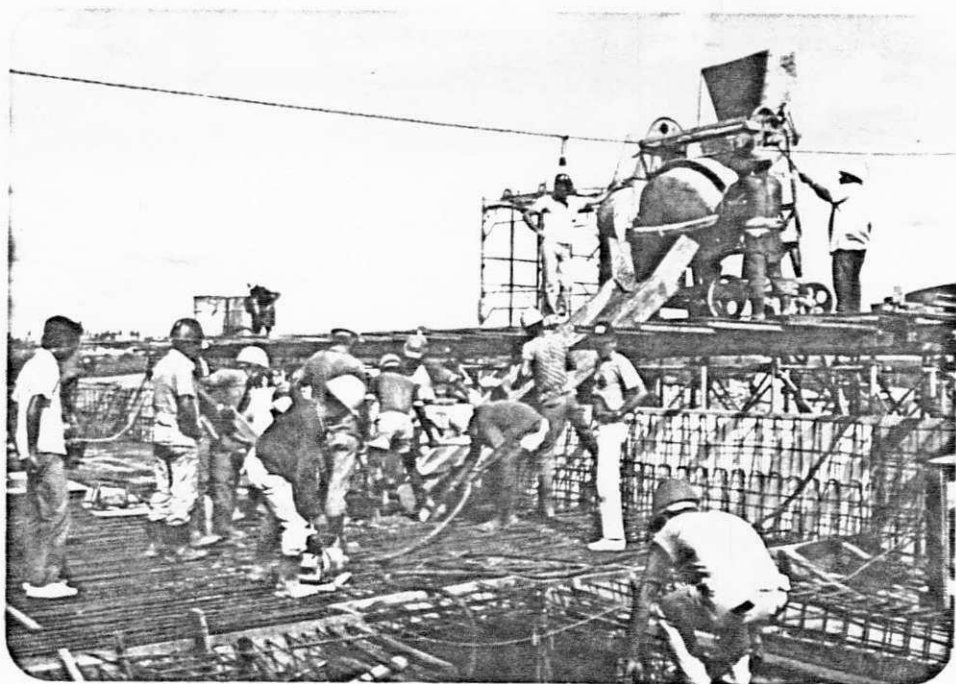
Foto 27 - Concretagem de parte do trecho I - Pista Direita, destacando-se o guar- da-rodas, os vibradores e a bento - neira preparando concreto.
