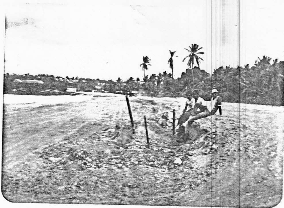
Foto 11 - Vista do aterro desta Avenida, det a lhando as ruturas ocorridas.
