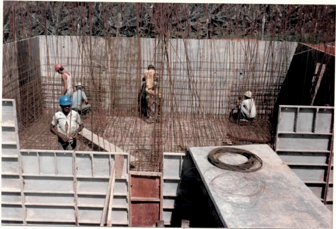
3. Reservatório Apoiado de 150 m 3 - Dona Inês
