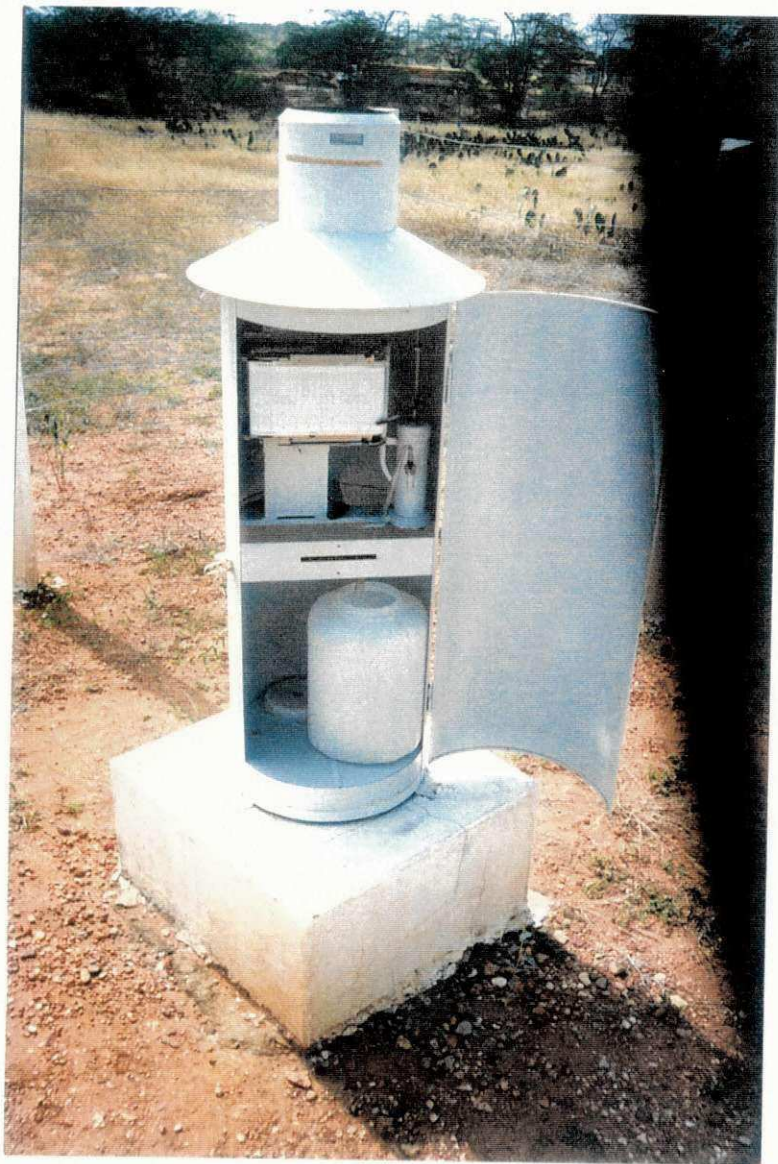
FIG.4 - Pluviógrafo Sifão n.:01
