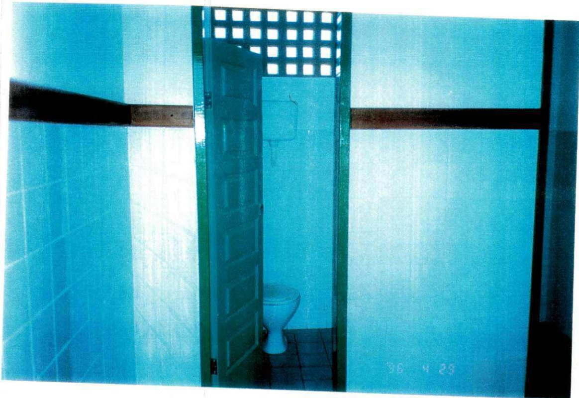
BANHEIROS: APARELHOS SANITÁRIOS
