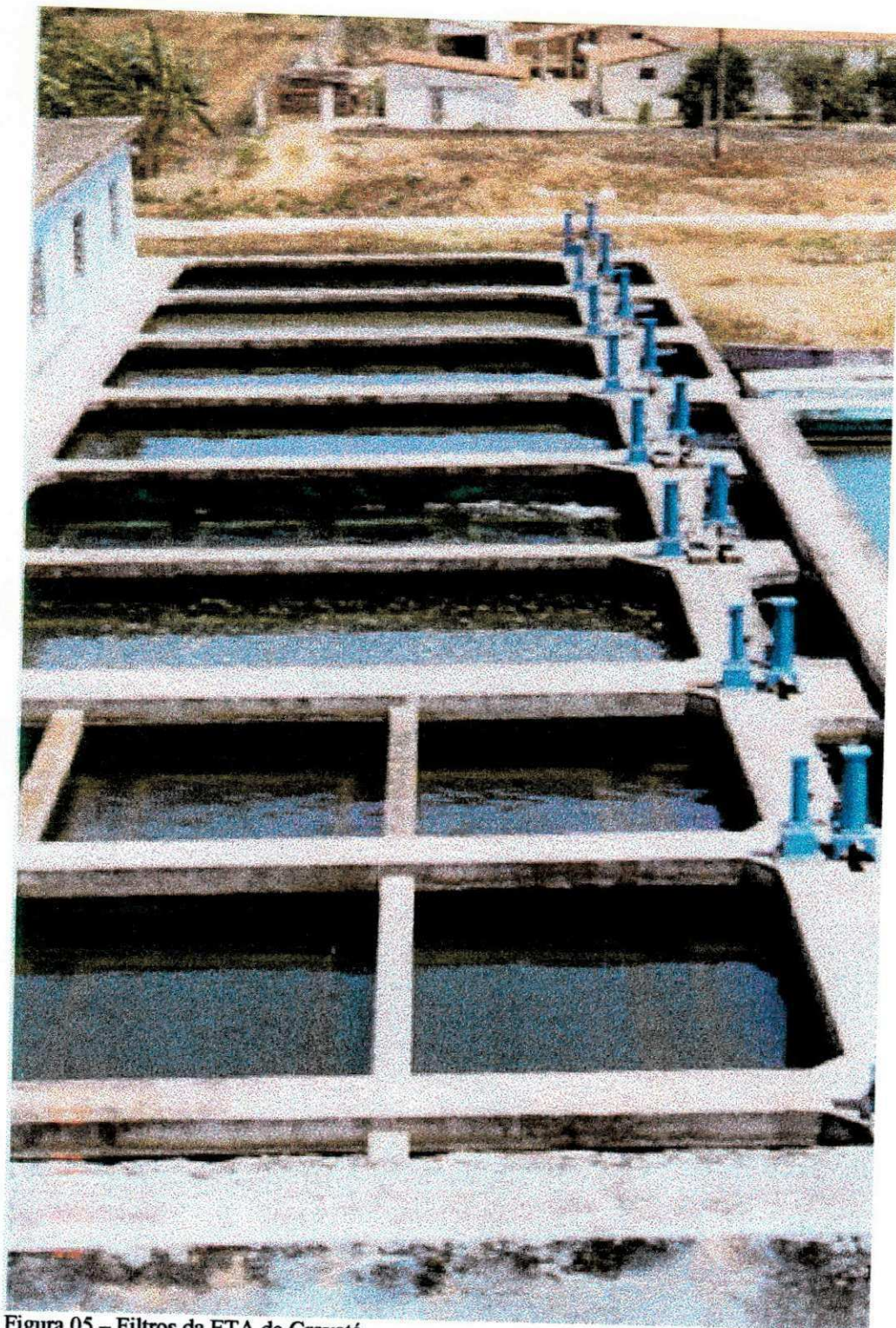
Figura 05 – Filtros da ETA de Gravatá
