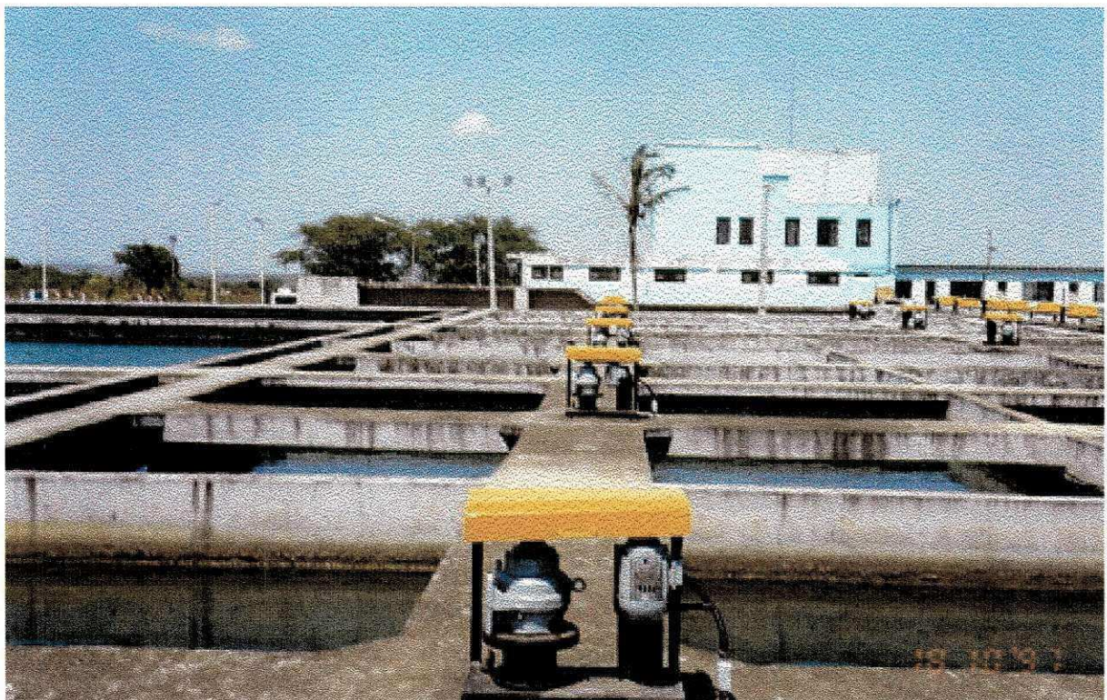
Figura 02 - Floculadores Mecânicos de Fluxo Axial da ETA de Gravatá
