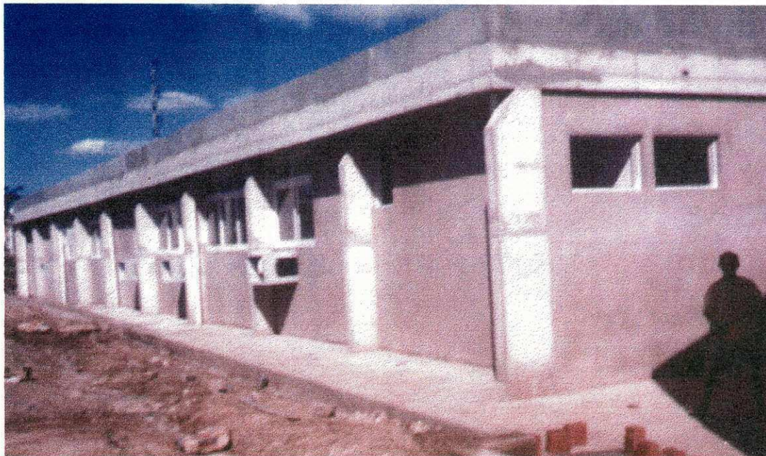
Caixas de Ar /Cond. / Vista de Fundo
