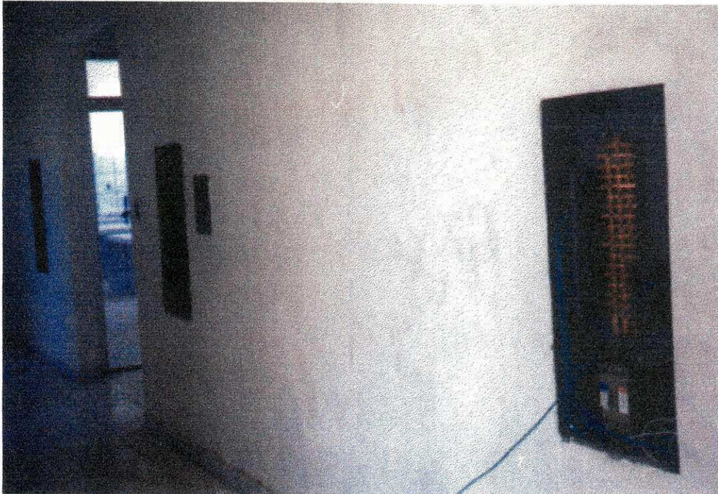
Detalhe dos Quadros de Disjuntores
