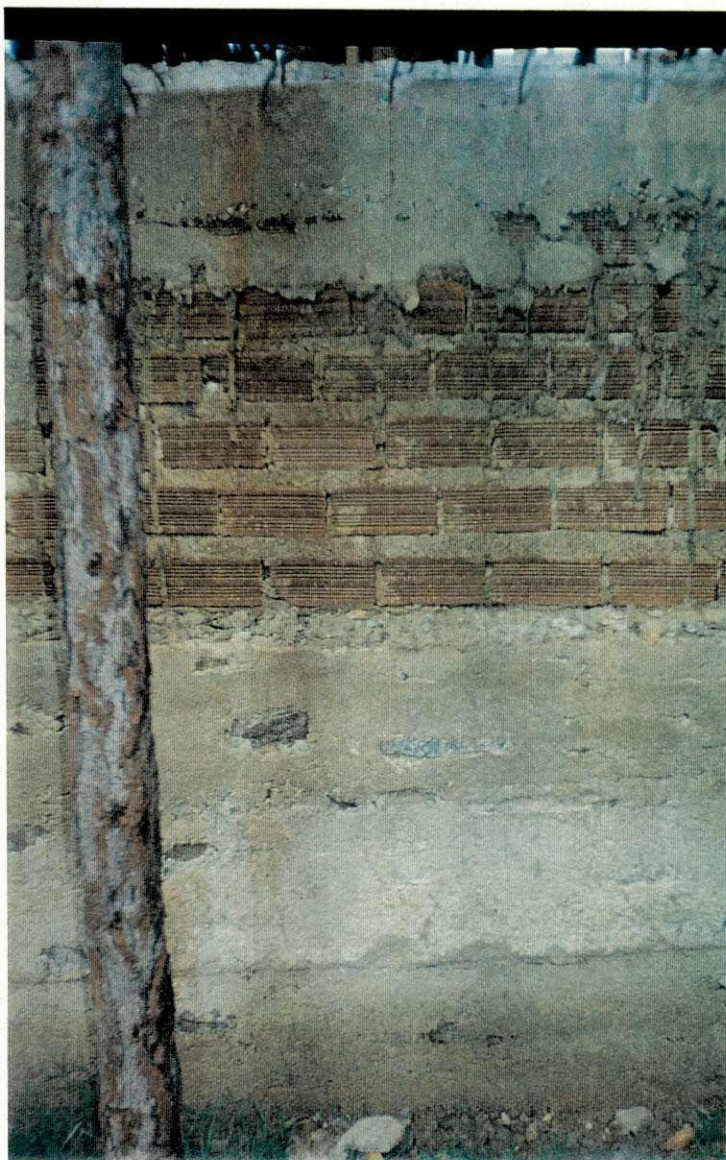
Figura 08 – Embasamento com alvenaria de pedra e de alvenaria de tijolos, na parte superior tem-se o cintamento
