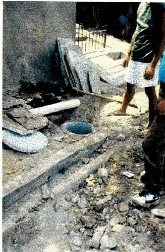
Fig. 07 (Caixa de Inspeção)
