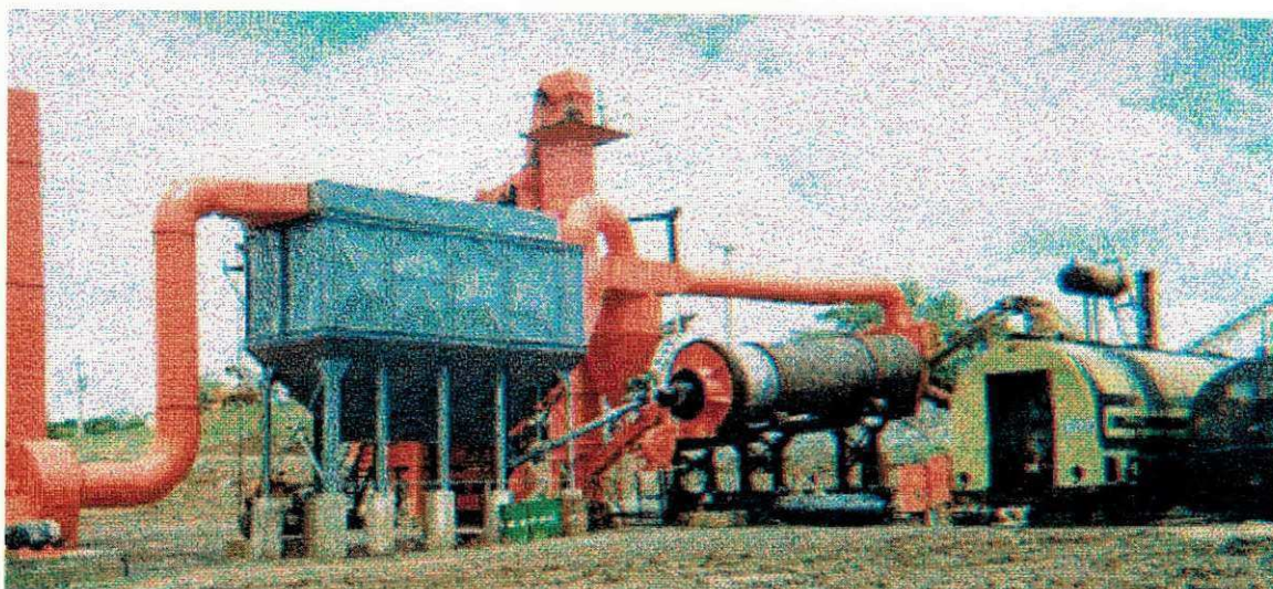
Figura 6 – Usina de asfalto
