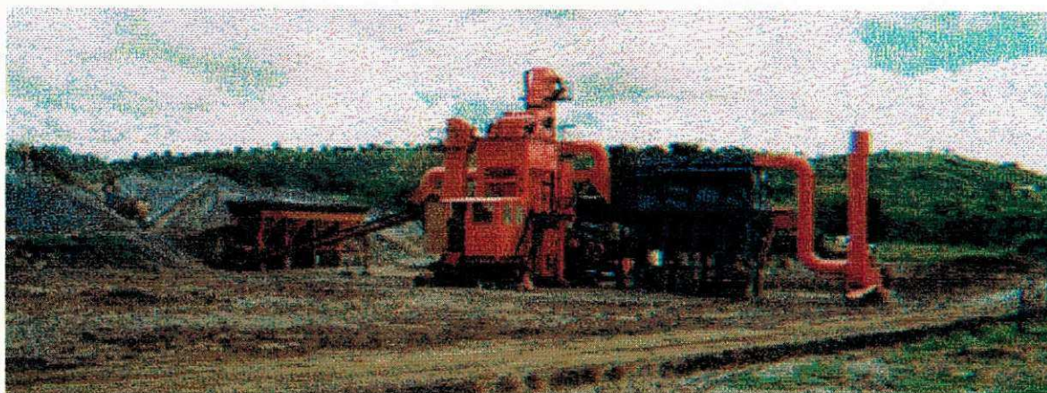
Figura 7 – Usina de asfalto
