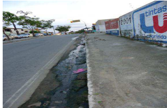
Figura 8 – Esgoto a céu aberto em frente ao IC-CG.
