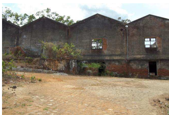
FIGURA 28: Ruínas dos armazéns construídos pela SANBRA, após anos 1940 denominada de CONDE da firma Nascimento & Companhia. AUTOR: MARQUES, 2013.
