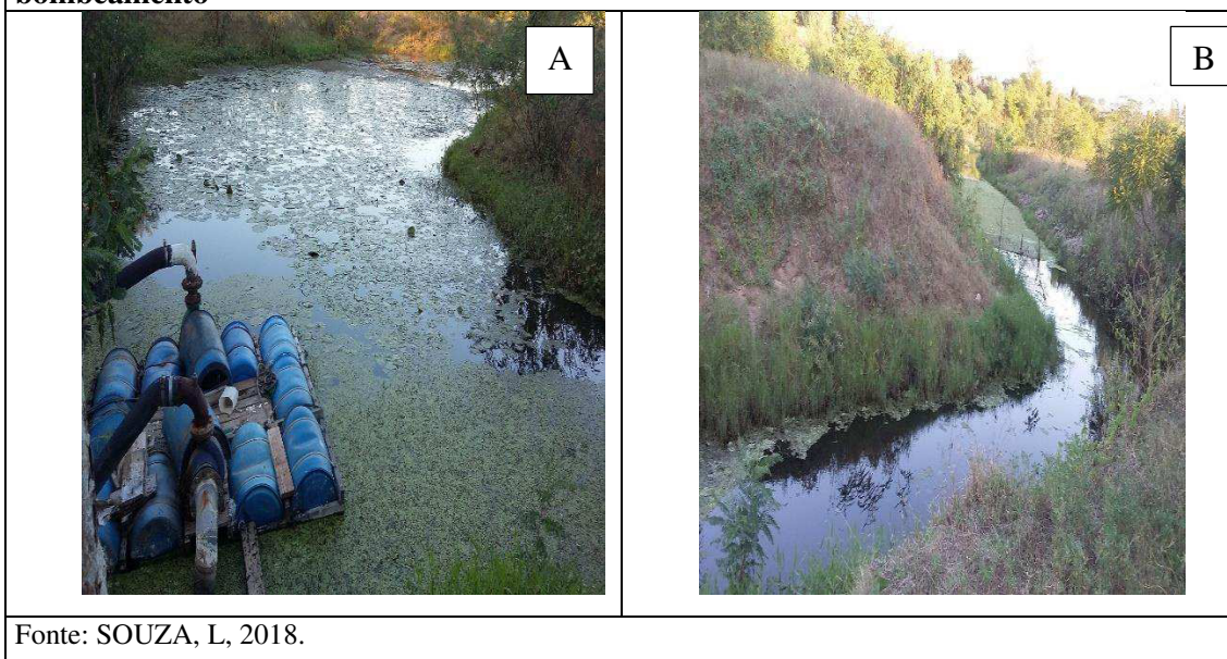
Figura 12. Bombeamento das águas para os tanques de camarão, as margens do Rio Paraíba do Norte, Mogeiro – PB. A) Dois motores bomba de 30 CV's para captação de água para os tanques de camarão, dentro do canal fluvial do Rio Paraíba do Norte, Mogeiro – PB e B) Canal para transposição de água do leito menor para as áreas de bombeamento
