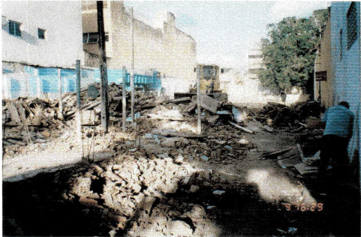
Foto 1 – Demolição e Remoção de Entulhos, através de um processo mecânico, utilizando-se máquinas especializadas.
