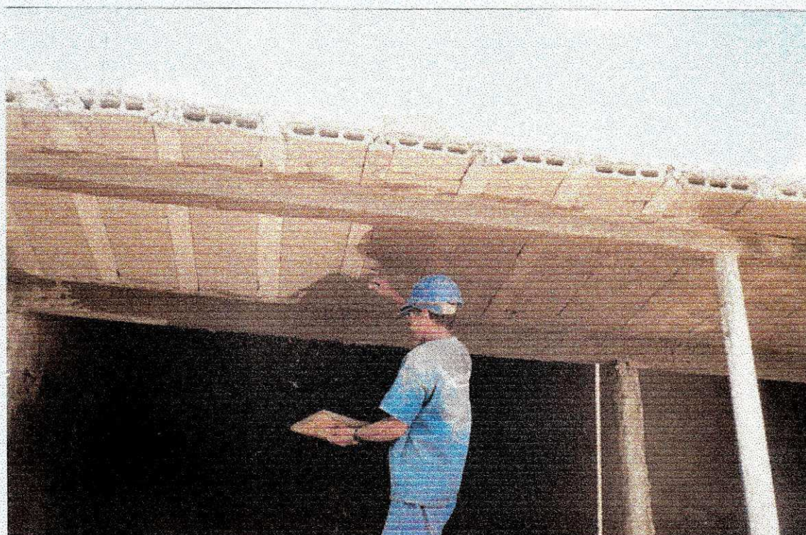
Foto 4 – Vista da laje pré-moldada de forro, bem como da aplicação de chapisco na mesma.
