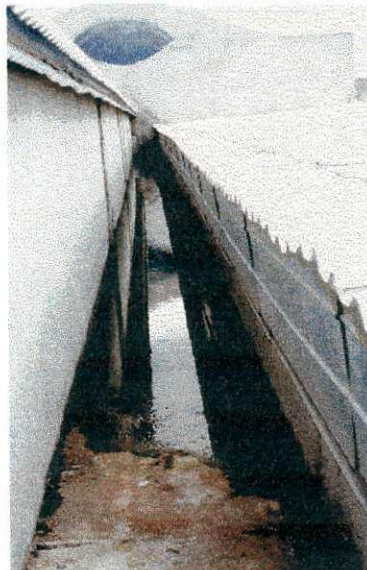
Foto 1 – Água empoçada na calha do telhado do shopping
