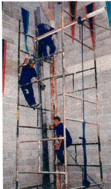
Foto13 – Trabalhadores da J.R. sem EPI's
