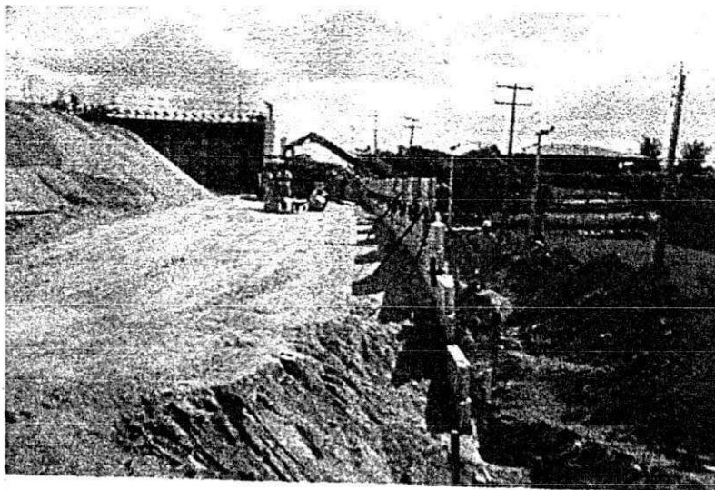
FOTO 09 - Detalhe da execução da Terra Armada sobre passagem inferior de Gravatá na estaca 400.
