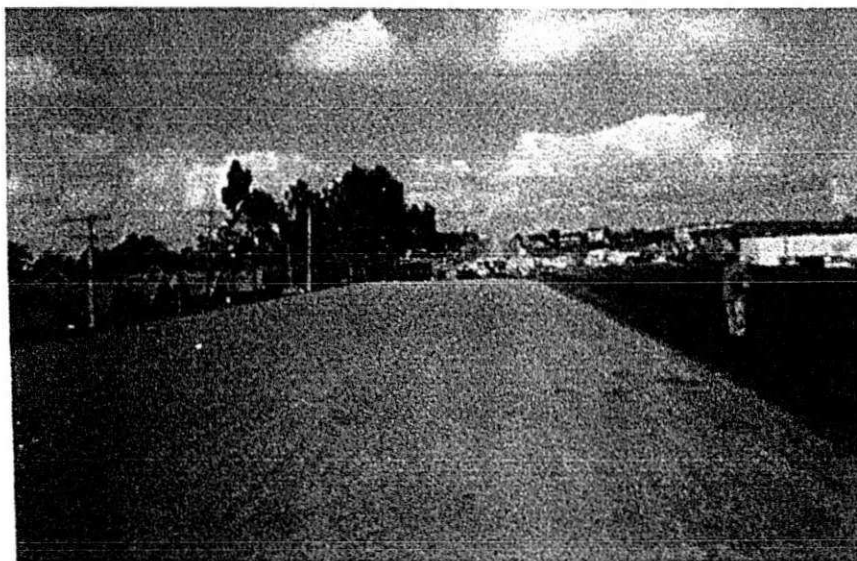
FOTO 08 - Detalhe do fechamento de uma das camadas do corpo de aterro no Viaduto sobre passagem inferior de Gravatá na estaca 400.
