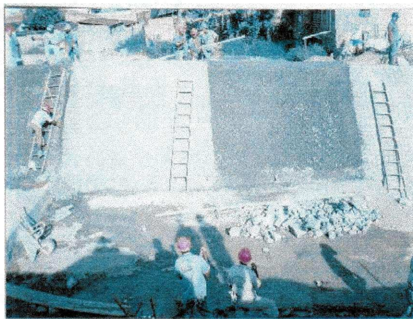
Foto 8: Parede do Canal
