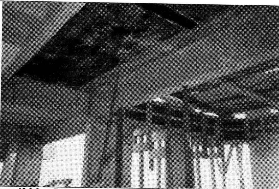
Figura 10.9.2 – Retirada das fôrmas das lajes com um instrumento apelidado de “pé-de-cabra” (vergalhão com um gancho na extremidade).
