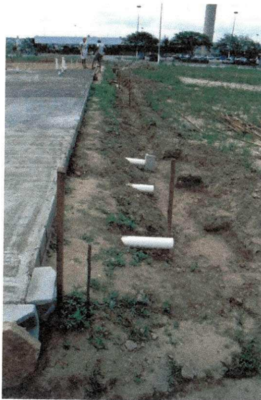
Foto: 4 – Tubulação do esgoto a espera
