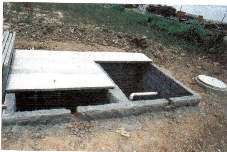
Foto: 5 (b) – Tanque séptico dos banhos.
