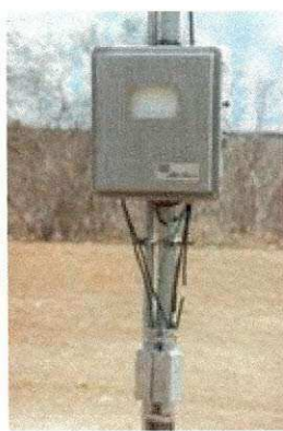
(a) PLC de um poço
