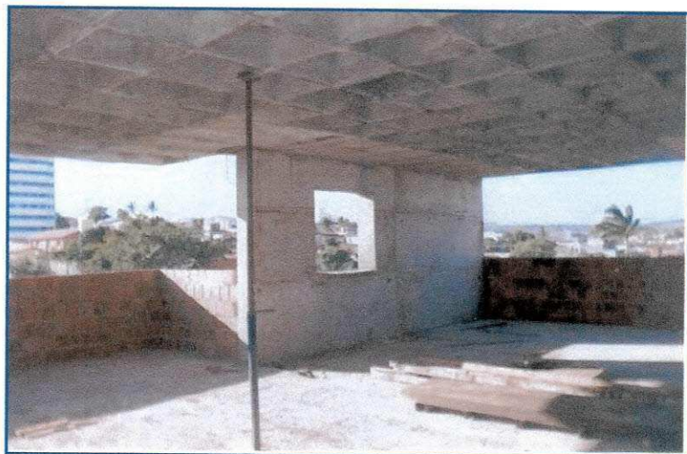
Figura 12 – Abertura deixada no pilar-parede.
