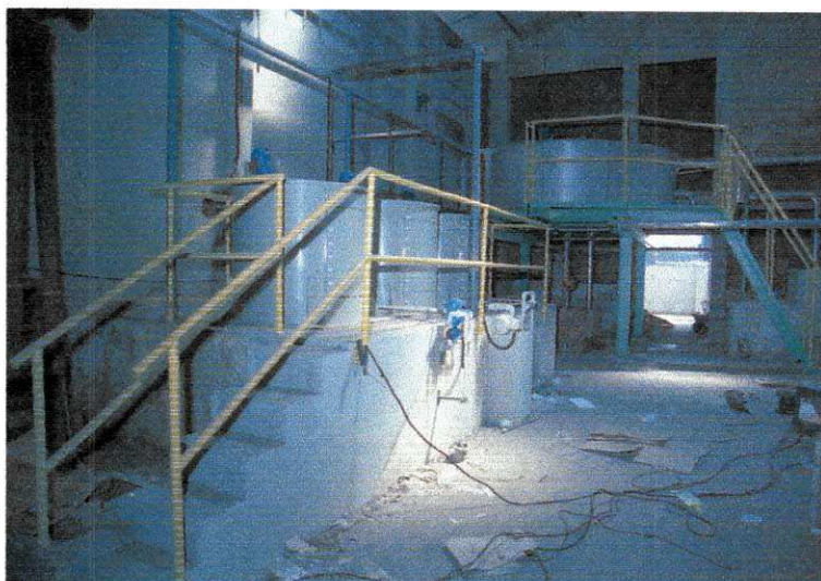
Figura 5.7 – Tanques dosadores de polímeros.
