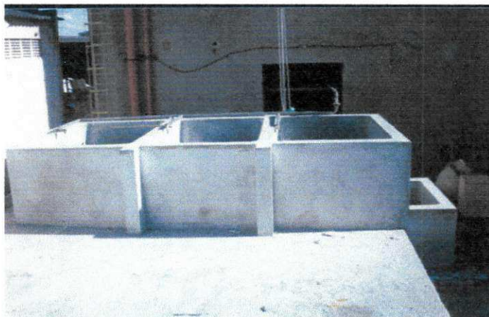
Figura 5.13 – Vista geral do leito de secagem.
