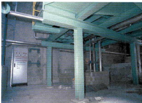
Figura 5.10 – Estrutura de aço de sustentação do clariflotador.
