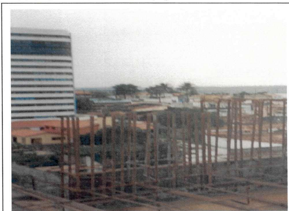
Foto 4: Detalhe da armadura de combate ao efeito de punção.
