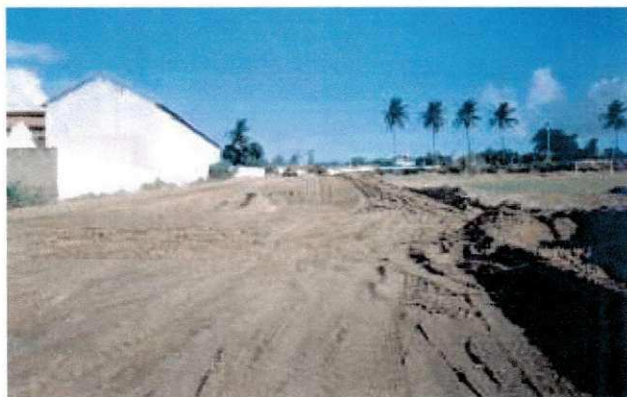
Fig.1 – Rua Perimetral 2 ( Necessidade de aterro para se chegar à cota de projeto ).
