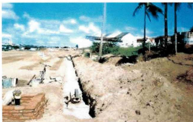
Fig.3 – Execução dos drenos Porosos (Acima dos Drenos, camada filtrante de brita e, logo acima, Camada de Brita, para melhor absorção).
