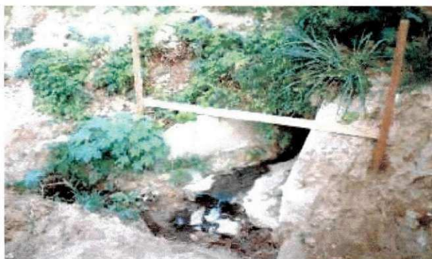
Fig.3 – Esgoto sendo jogado às margens do trecho a ser executado, daí a necessidade de se executar drenagem, a fim de não comprometer as camadas de Leito e sub-leito.
