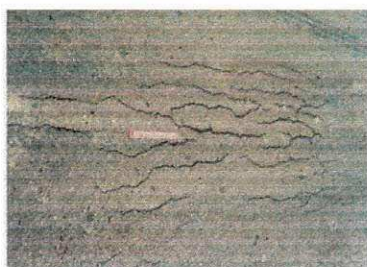
Figura 8: Trincamento por fadiga. Nível de severidade baixo.
