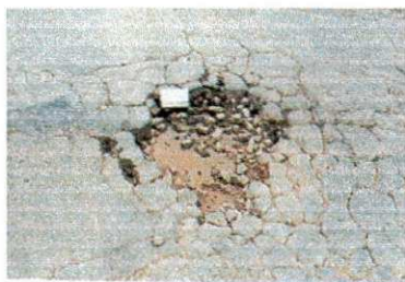
Figura 14: Buraco (panela). Nível de severidade baixo.
