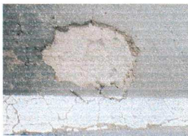
Figura 15: Buraco (panela). Nível de severidade médio.
