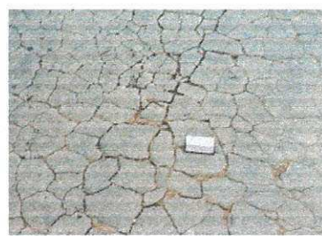
Figura 10: Trincamento por fadiga. Nível de severidade alto.
