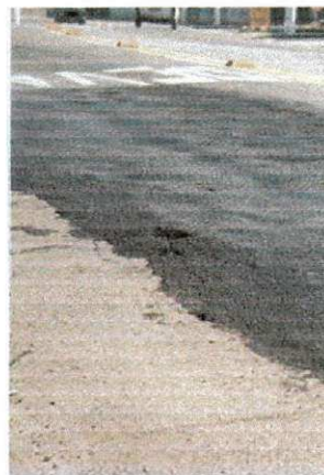
Figura 11: Deterioração de remendo. Nível de severidade baixo. Figura 12: Deterioração de remendo. Nível de severidade médio. Figura 13: Deterioração de remendo. Nível de severidade alto.
