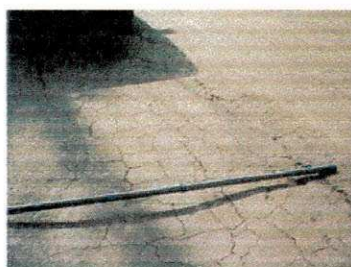
Figura 9: Trincamento por fadiga. Nível de severidade médio, acompanhado por afundamento de trilha de roda.
