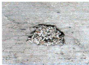
Figura 16: Deterioração de remendo. Nível de severidade alto.
