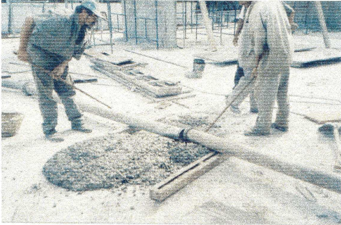
FOTO 17 – ROMPIMENTO DA TUBULAÇÃO DE BOMBEAMENTO
