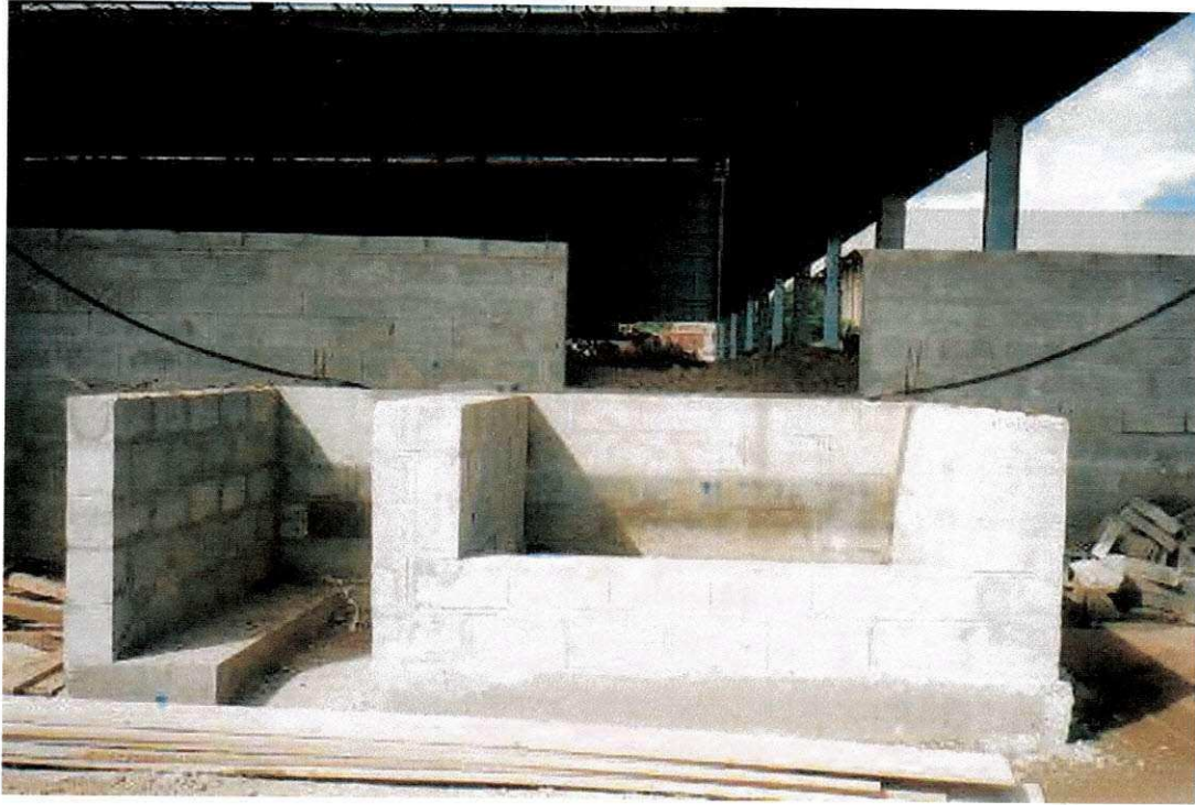
Foto 17 (Baías de distribuição)
