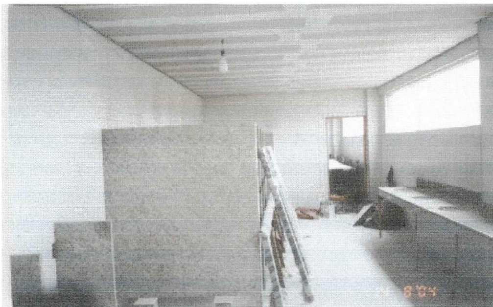
Figura 8 – Apresentação do forro de gesso acartonado
