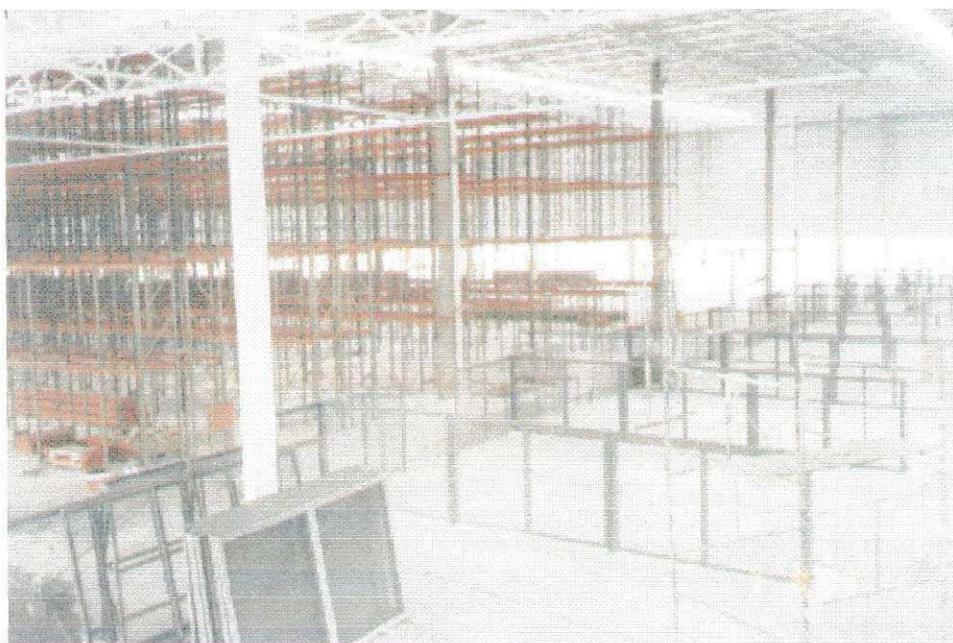
Figura 7 – Vista superior da montagem dos Box. À esquerda, as estantes já montadas para o início do funcionamento do galpão.
