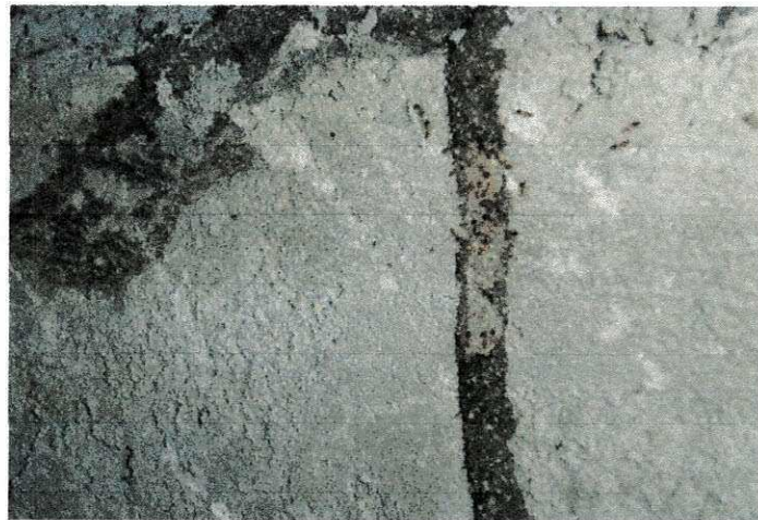
Foto 4 – Rastro de cupim nas estruturas
