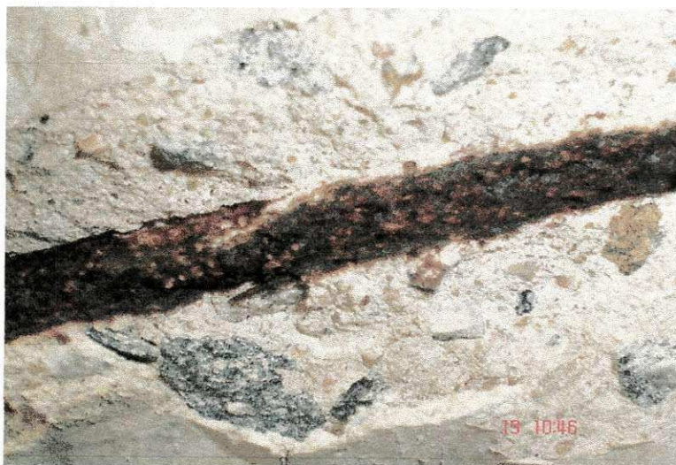
Foto 2 – Corrosão da armadura
