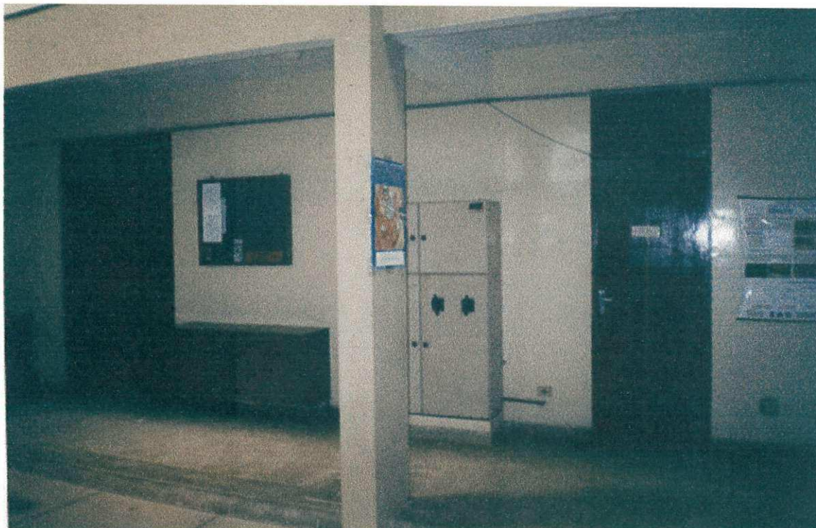
FOTO 07 – PORTAS DA BIBLIOTECAS E SALA DE ESTUDOS MENOR (À ESQUERDA) E DA SALA DE ESTUDOS MAIOR (À DIREITA). ESTAS DUAS SALAS DEVERÃO SER UNIDAS, TORNANDO-SE UMA APENAS, JUNTANDO-SE À BIBLIOTECA. A PORTA DA DIREITA DEVERÁ SER RETIRADA, JÁ QUE SERÁ ABERTA UMA PASSAGEM ENTRE A SALA DE ESTUDOS E A BIBLIOTECA.
