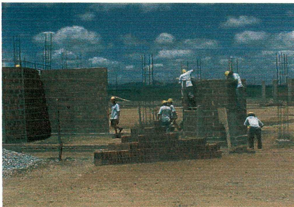
Figura mostra um dos serviços a serem controlado pela empresa execução de alvenaria em blocos cerâmicos.
