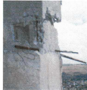
Figura 22 - Segregação de concreto e exposição da armadura.
