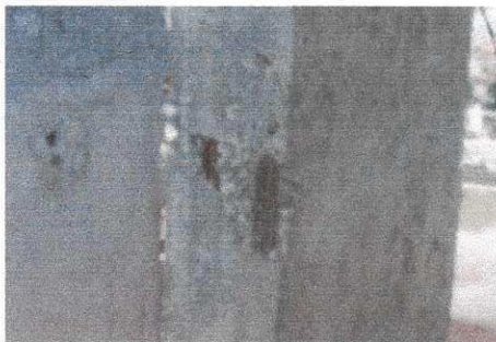
Figura 23 - Segregação de concreto e exposição da armadura.
