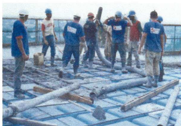
Figura 10 - Erro na execução do concreto usinado.
