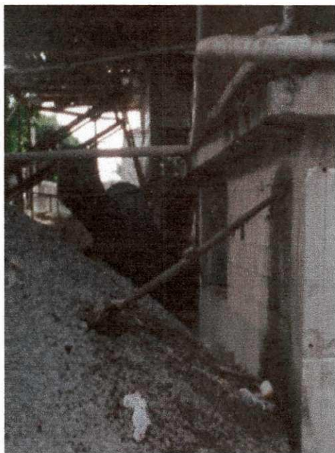
Figura 25 - Armazenamento da brita em péssimas condições.
