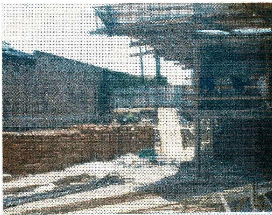
Figura 05: Foto do canteiro de obra. Observa-se as ferragens depositadas diretamente no solo.
